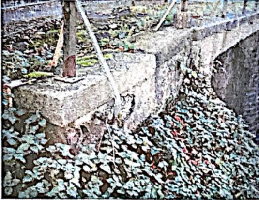
FLÜGEL SÜDOST AUSGEBROCHEN VERWÖLBT
