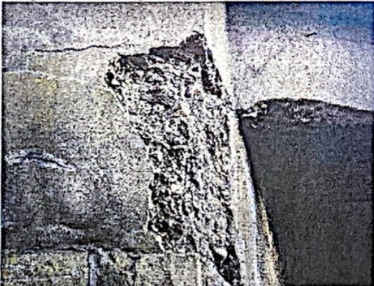
ABPLATZUNG AM FLÜGEL NORDWEST
