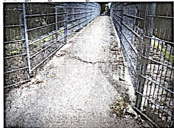
ABSACKUNGEN UND RISSE IM BELAG
