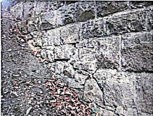
MAUERWERK GELOCKERT FLÜGEL NORDWEST
