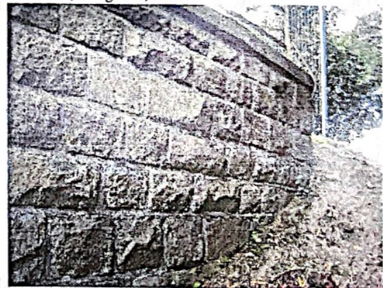
GERISSENE FUGEN AM FLÜGEL SÜDWEST
