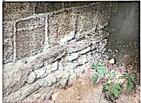
GELOCKERTES MAUERWERK AM WIDERLAGER NORD
